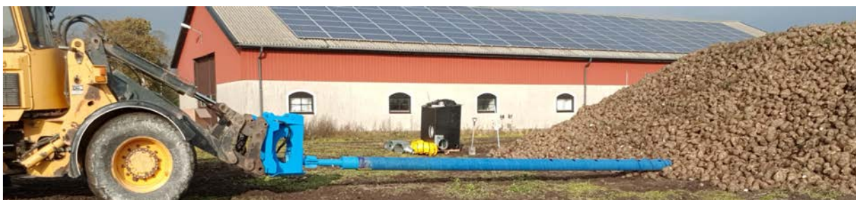
Figur 1. Här skrivs ventilationsröret in i en betstuka med den frontmonterade, hydrauldrivna skruvmaskinen.
